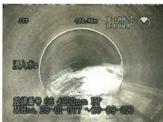
継手からの地下水の流入（管内調査）
