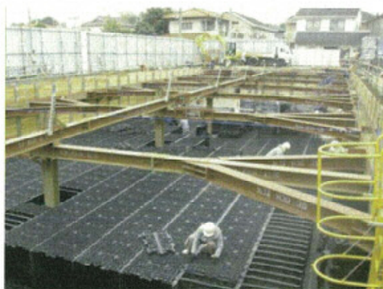
雨水貯留施設の整備
