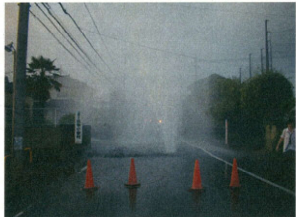
2008年8月の漏水状況
