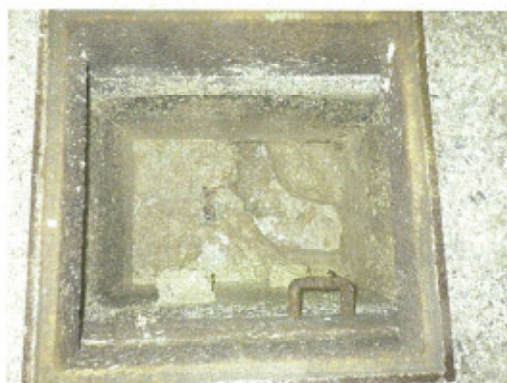
ラード等堆積状況（人孔内点検）
