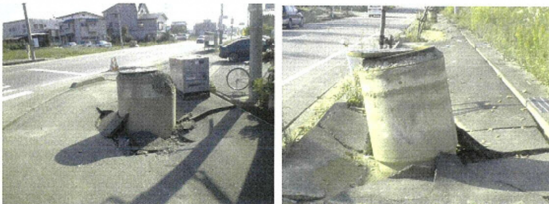
マンホール浮上状況（新潟県中越沖地震時の例）
