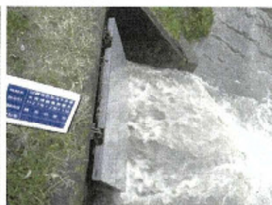
雨水吐口（雨天時）
