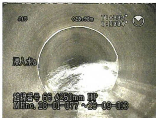
継手からの地下水の流入（管内調査）
