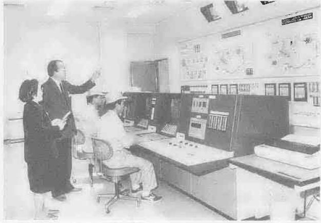
東清掃センターの全機能をコントロールする中央制御室
