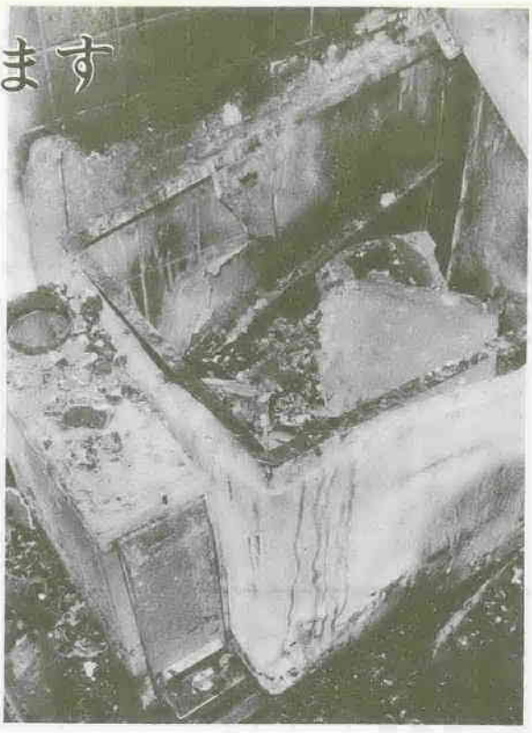
あやうく全焼...原因は栓からの漏水
