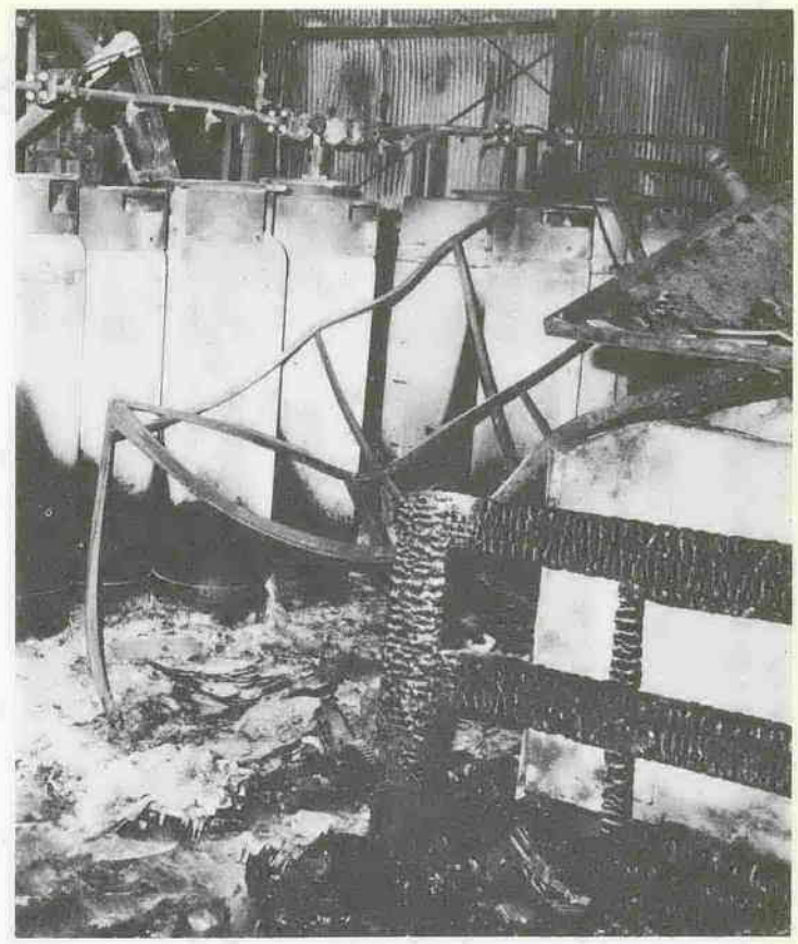
▲「火災現場」東京シリコン(株)、昨年12月1日、22時31分発生。屋根や外壁を焼損、西北西の風「風力2m」、湿度87%
